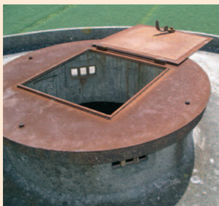
COUVERTURE SANS GARDE-CORPS, CAPOT DÉGRADÉ
